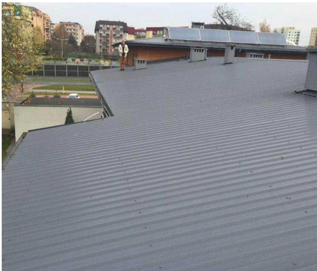
Rys 4. Dach domu parafialnego przeznaczony do inwestycji wraz z zainstalowanymi kolektorami słonecznymi
